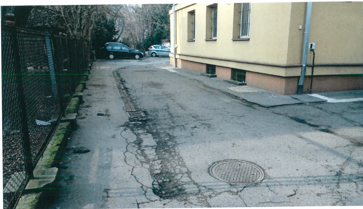
Droga dojazdowa do garaży od strony ulicy – widoczne zniszczenia nawierzchni
