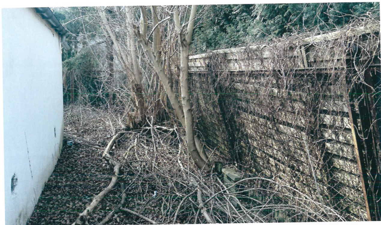
Uszkodzone ogrodzenie za budynkiem garaży, drzewa – samosiejki w linii ogrodzenia(do wycięcia)
