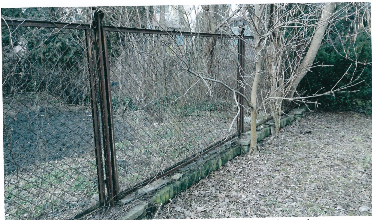
Fragment ogrodzenia od strony zachodniej – widoczne uszkodzenie cokołu, przęsła w znacznym stopniu skorodowane.
