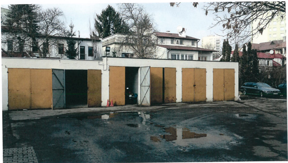
Budynek garaży – zniszczona nawierzchnia, brak odpływu
