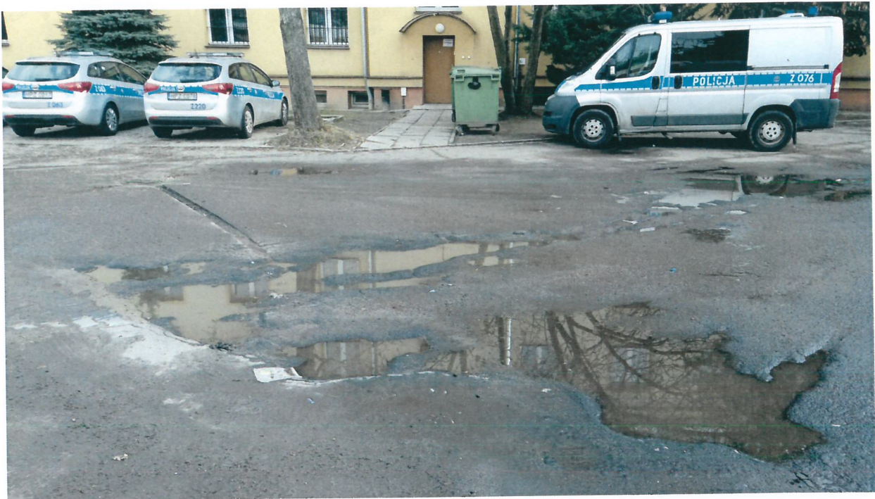
Plac manewrowy przed budynkiem garaży – brak odwodnienia
