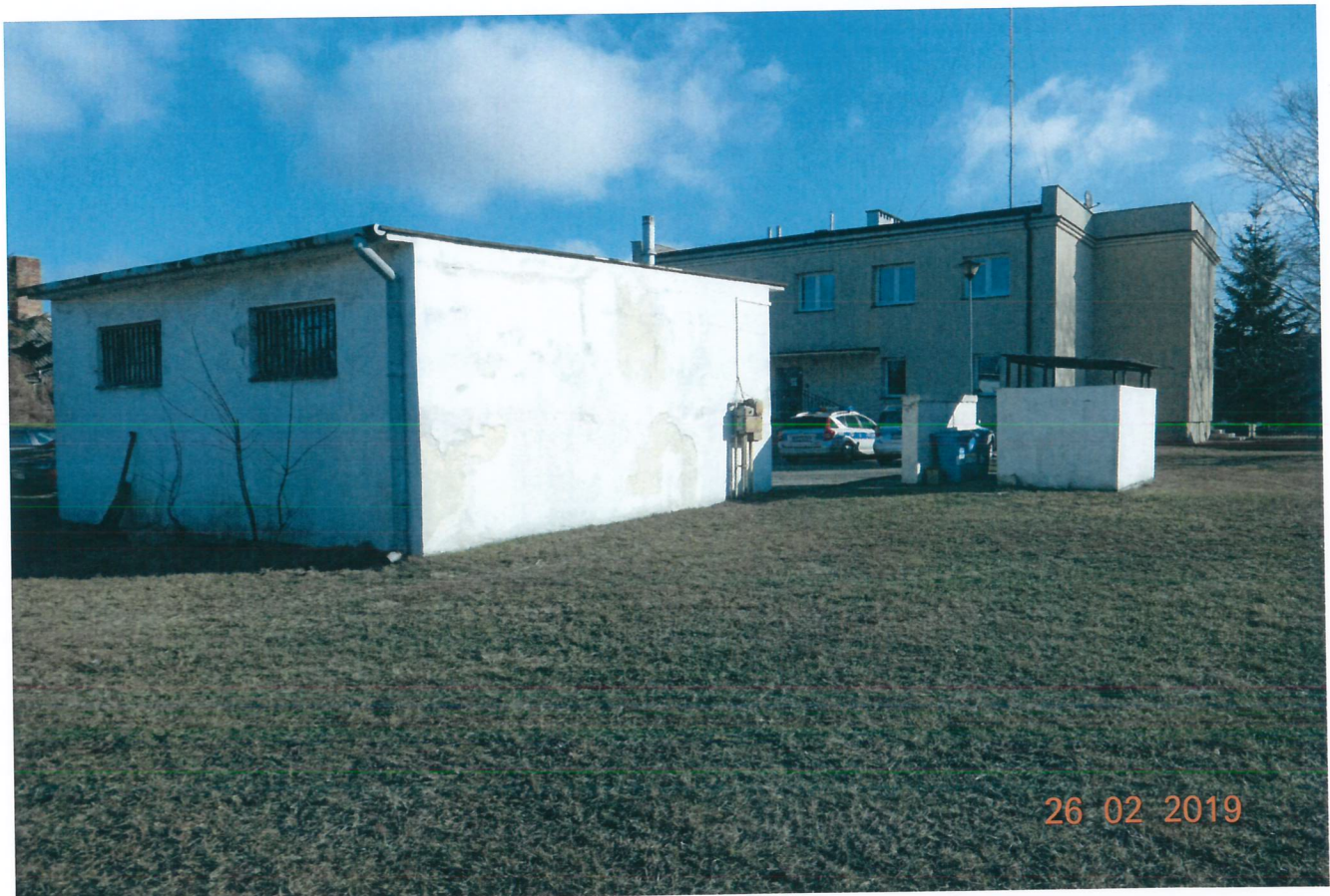
Obiekt nr 2 – Budynek garażu (widok z tyłu); na prawo - Obiekt nr 3 – Wiata śmietnikowa, w głębi bud. Komisariatu Policji
