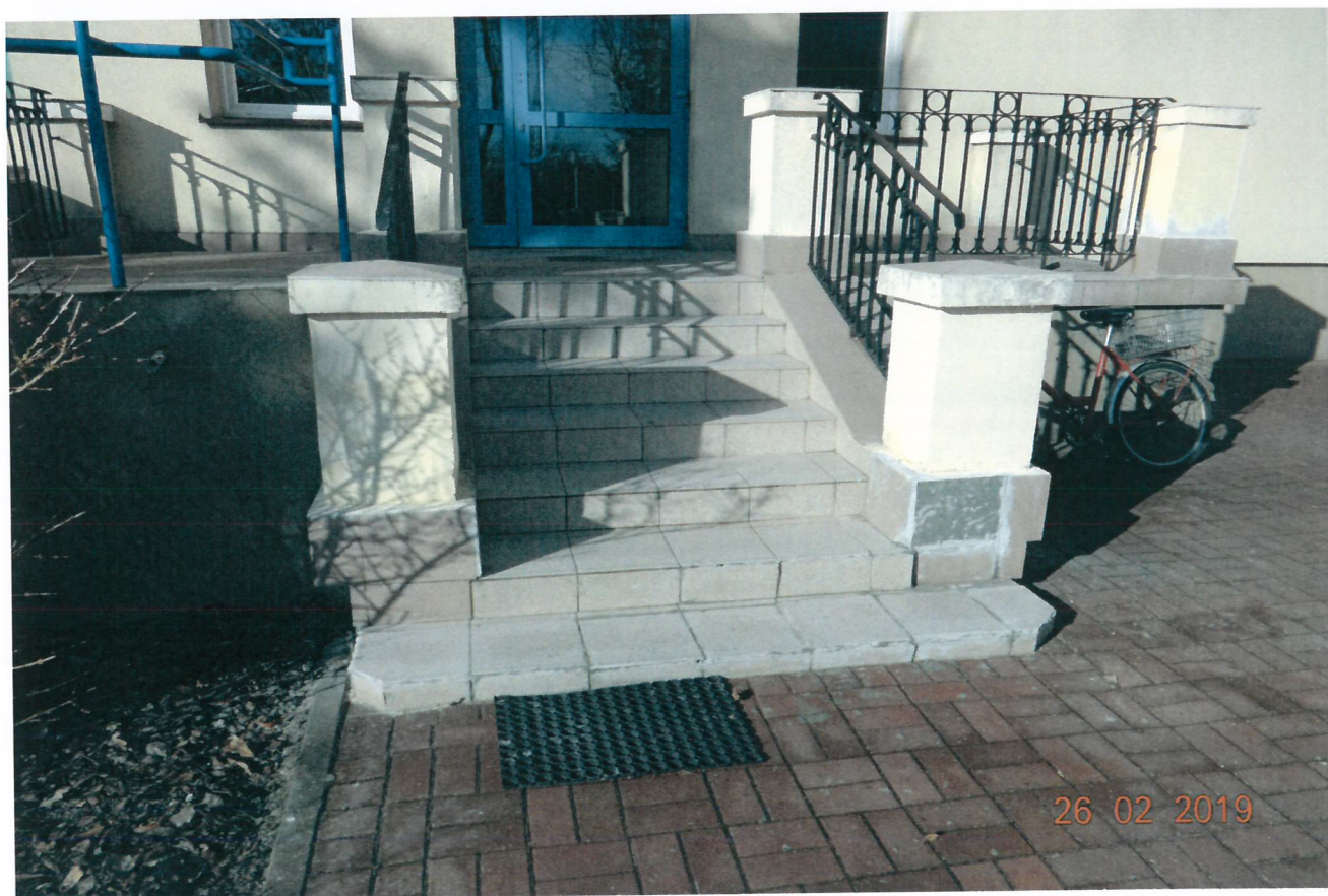
Schody zewnętrzne (wejście do budynku KP) – fragment do reperatury, malowanie balustrady
