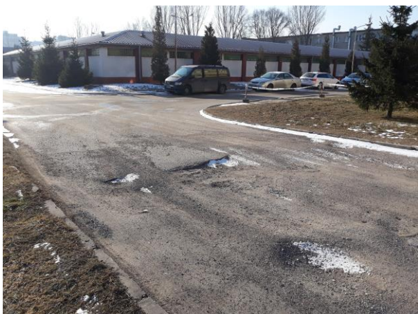
1. Połączenie drogi betonowej z częścią asfaltową – stan na dzień 05.03.2018 r.
