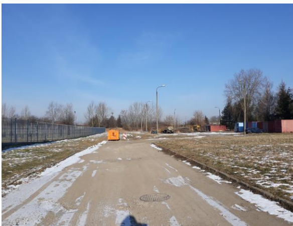
4. Stan drogi betonowej za wjazdem na plac manewrowy przed magazynami 05.03.2018 r.
