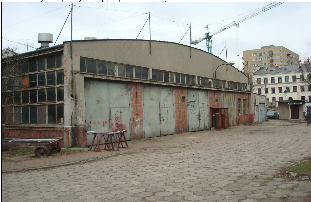
- widok ściany zewnętrznej hali z pęknięciami - elewacja wschodnia
