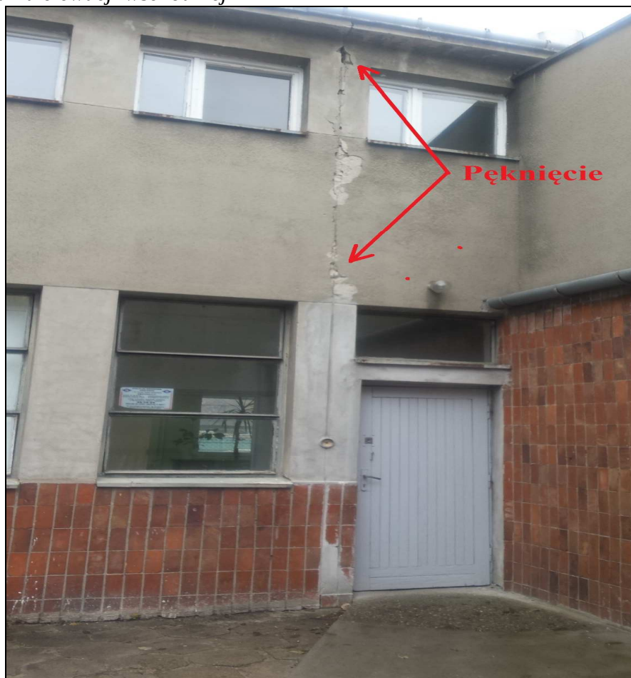
- widok pęknięcia na elewacji wschodniej
