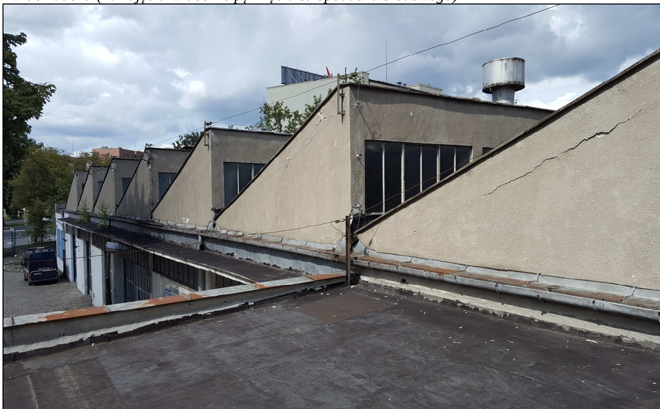
- widok dachu (na zdjęciu widoczne pęknięcia stropodachu szedowego)
