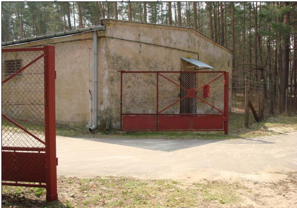
Fot. 31. Widok terenu od elewacji budynku E3, E4. Widoczne istniejące ogrodzenie zewnętrzne terenu „technicznego” i brama - do wymiany (przebudowy).
