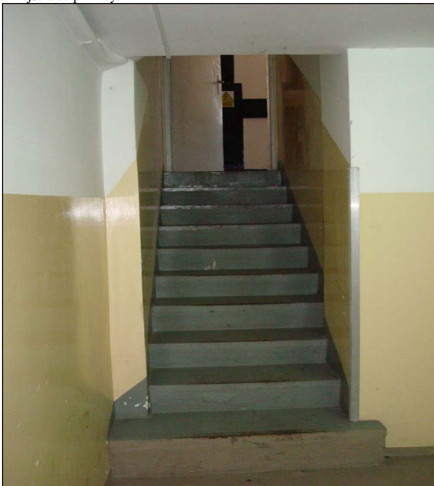
Wymiana kotła grzewczego w budynku Komisariatu Policji Warszawa Wilanów ul. Okrężna 57 Fot. 21. Widok zejścia do piwnicy.
