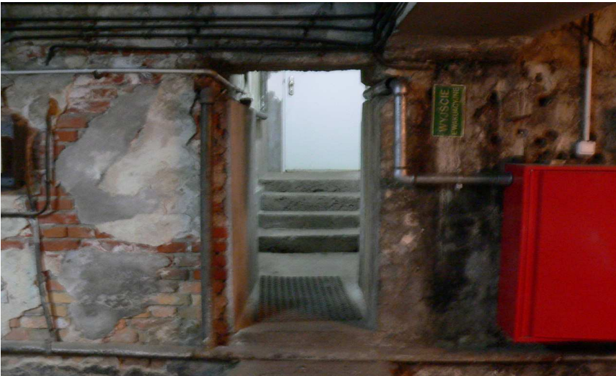
Fot. 6 i 7 Widok – wejście do garażu podziemnego z budynku administracyjno - biurowego (instalacja p. poż. ze skrzynką hydrantową);
