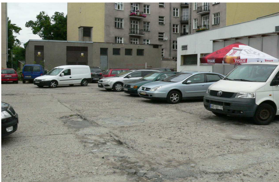
Fot. 2 Widok utwardzenia nad garażem podziemnym od ul. Okrzei (w tle budynek stacji trafo);
